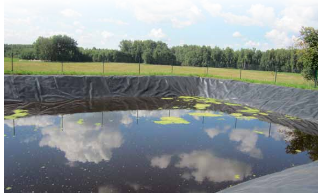
Efektīvs risinājums mēsli uzglabāšanai ir lagūnas tipa krātuves, kurās kūtsmēsli un urīns sajaucas līdz vircai. Uz 125 ziditājgovīm ir nepieciešama 500 m 3 liela krātuve, kura izbūvēta, izmantojot apmēram 440 m 2 lielu hermētisku, no necaurīdīga polietilēna veidotu izolējumu.
